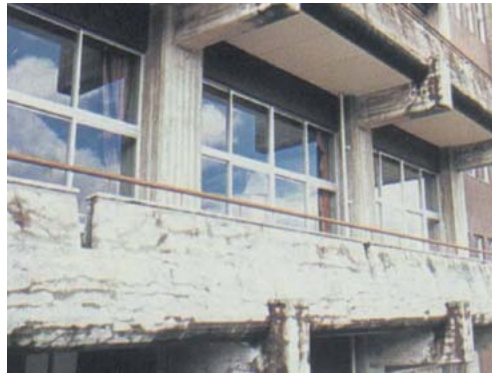
アルカリ骨材反応による 損傷の実例 Concrete Deterioration caused by Alkali-Aggregate Reaction
