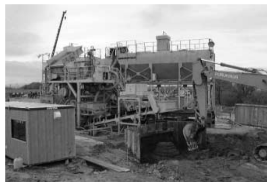
汚泥改良設備(石炭灰添加攪拌設備)
