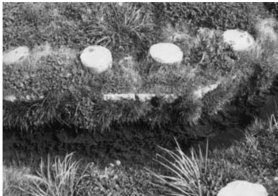
ウェットコンクリートパネルによる水路
