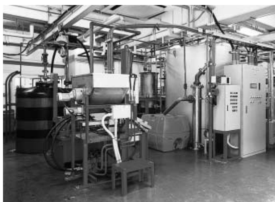
生ごみのメタン発酵装置
