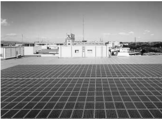
富士ゼロックス・海老名事業所の 屋根一体型太陽電池(110kWp)
